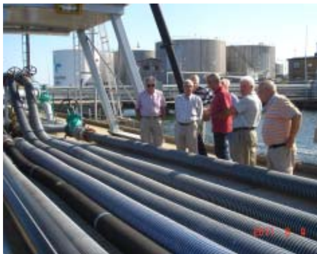
Imponerande rördimensioner vid oljekajen
